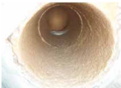
Conduit de circulation
