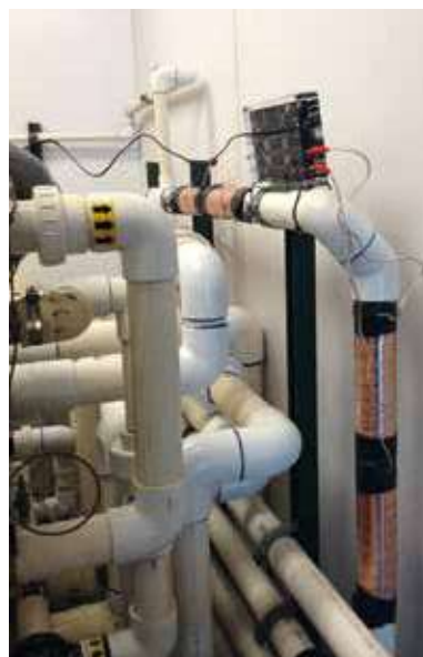
Vulcan 25 installé pour traiter l'eau du spa
