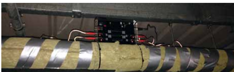
Unité Vulcan S25 installée avec isolation enveloppée dans les tuyaux
