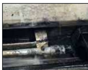
7 février : Observation visuelle de la machine 1 avant l'installation de Vulcan. Le mur et les buses ont du calcaire et des bactéries.
