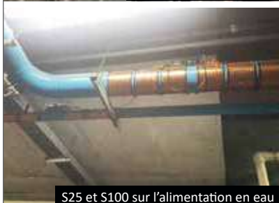
S25 et S100 sur l'alimentation en eau
