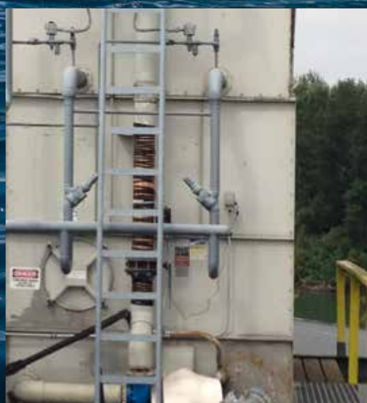
Vulcan S100 installé à l'extérieur
