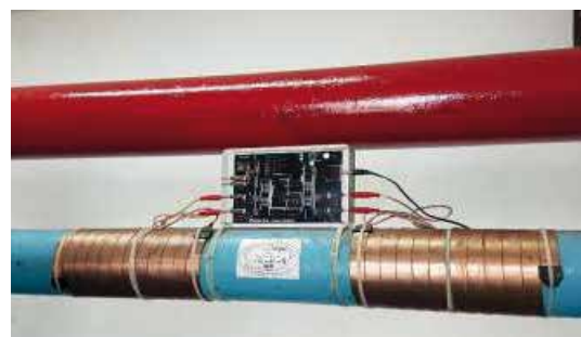
Le dispositif anti-calcaire électronique Vulcan S25 installé
