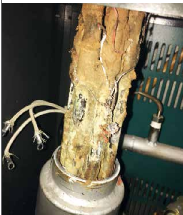
Échangeur de chaleur non traité pendant 3 ans.
