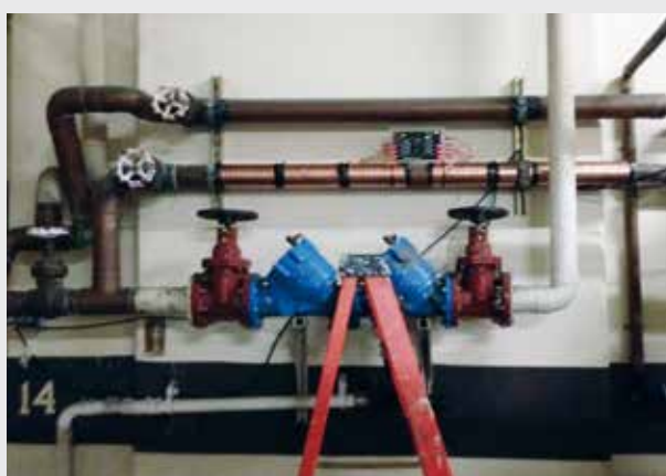
Vulcan S100 installé sur le système de purification
